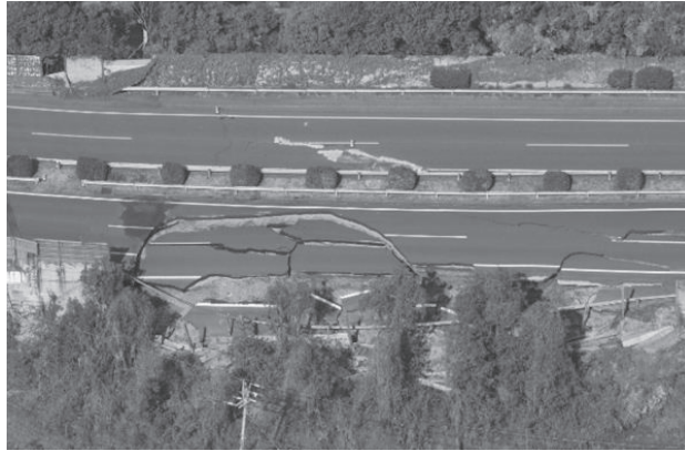
写真 13 熊本地震による九州自動車道の盛土法面の崩落 （益城バスストップ付近）
