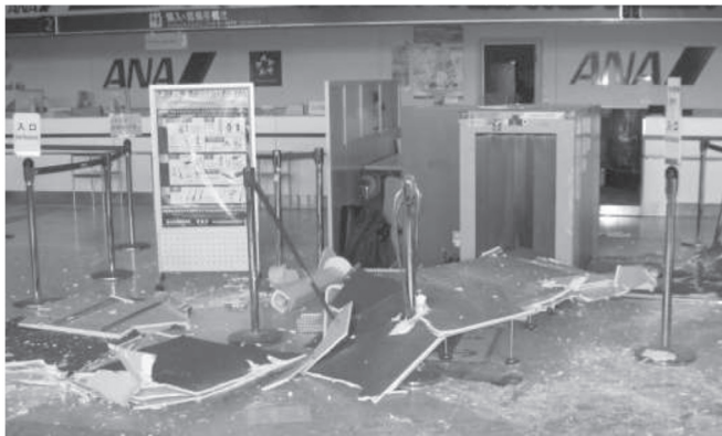
写真9 熊本空港ターミナルビルの被災
