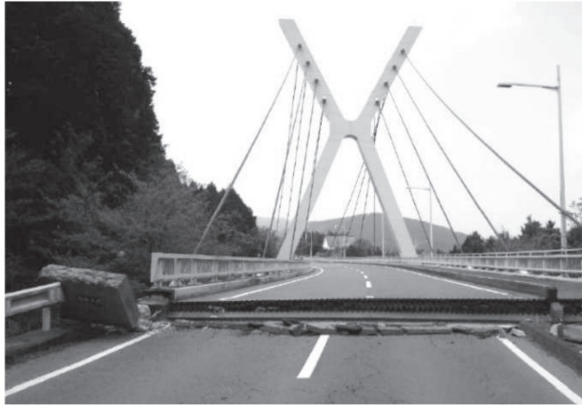
写真 15 桑鶴大橋の橋面の段差
