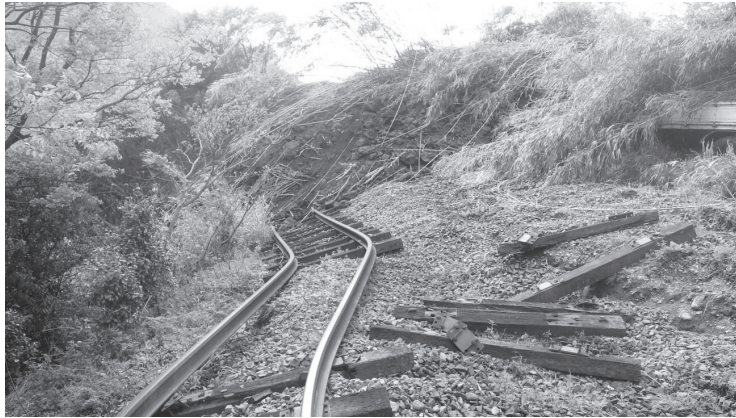
写真12 南阿蘇鉄道：土砂流入に伴うレールの大幅な移動と歪み
