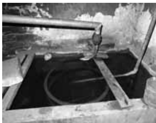
図2-14 冷却水槽内の渦巻き状パイプ
